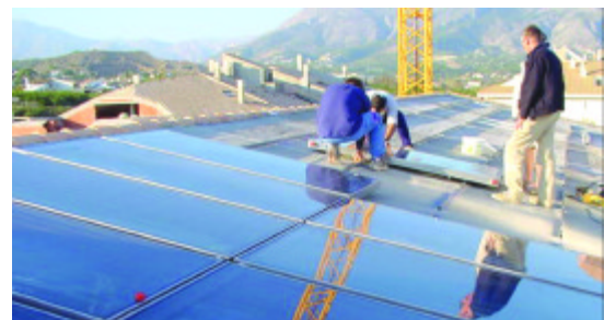
Bildet viser solpanel montert på tak (På Bærums Residencia).
