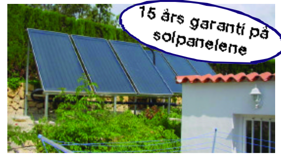
Solpanel kan også innstalleres i hagen eller annet sted på tomten.
