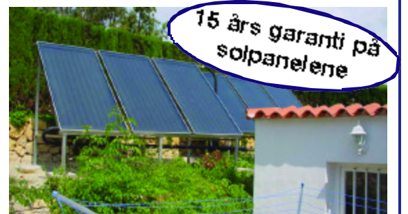
Solpanel kan også installeres i hagen eller annet sted på tomten.
