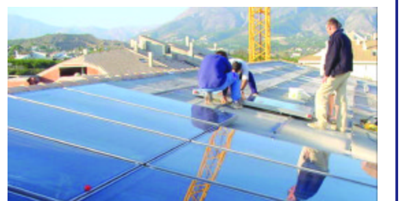
Bildet viser solpanel montert på tak (På Bærums Residencia).
